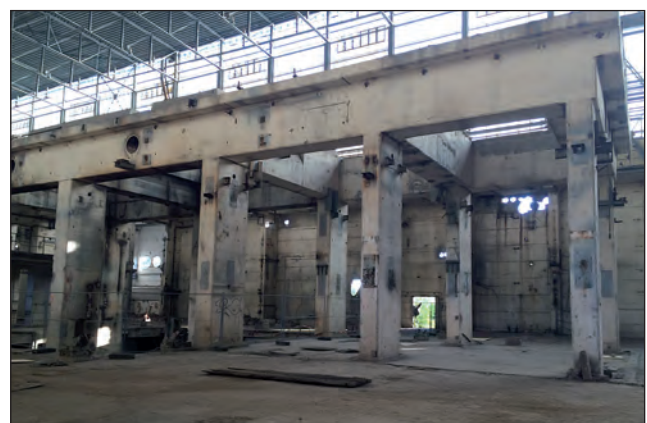
Abb. 2: Nördlicher Turbinentisch im Maschinenhaus
